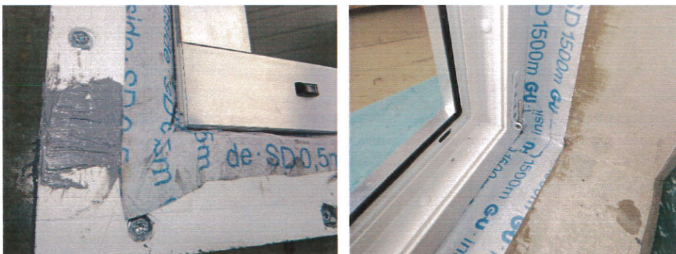
links: Fertiggestellter äußerer unterer Anschluss des Fensters Rechts: Fertiggestellter innerer unterer Anschluss des Fensters
